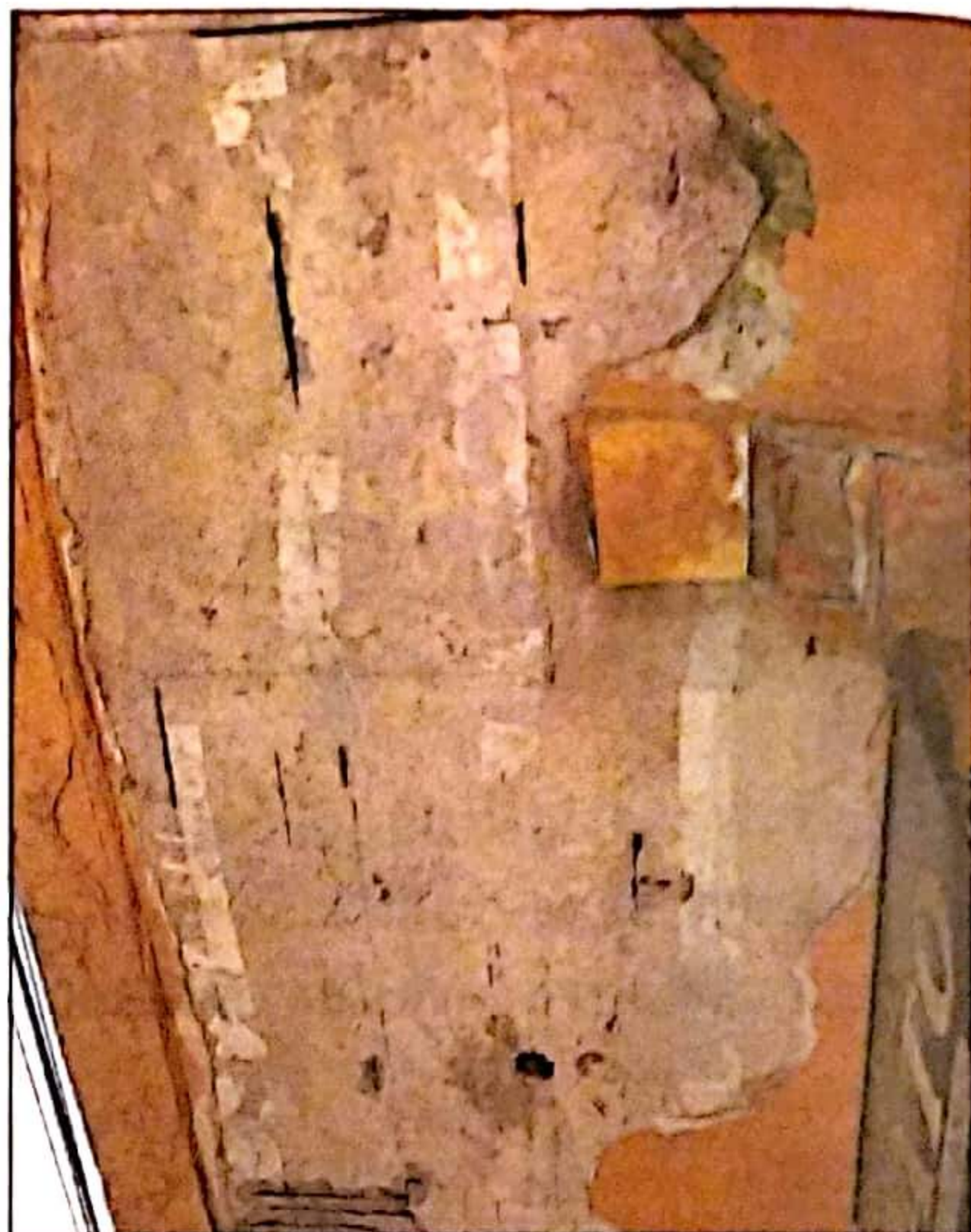
Na esquina das ruas Brás Cubas e General Câmara, estrutura dá medo
